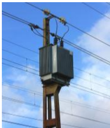
Modern sugtransformator men här placerad på en gammal och rostig transformatorstolpe
